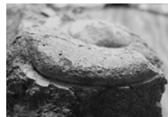
Wulst, welcher beim Nieten entstanden ist
